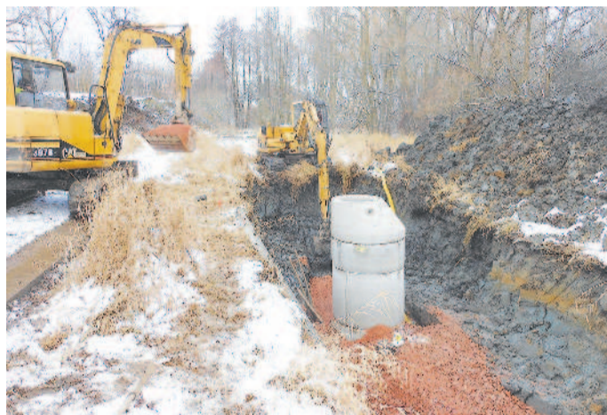
VÍCE NEŽ ROK TRVAJÍCÍ VÝSTAVBA kanalizace z Nedražic do Kostece je hotova. Foto: Obecní úřad Kostelec
