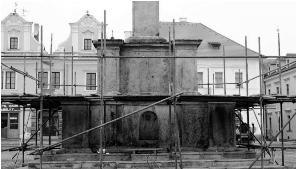
MOROVÝ SLOUP i stříbrské náměstí procházejí v současné době celkovou rekonstrukcí. Foto: Lukáš Hilpert
